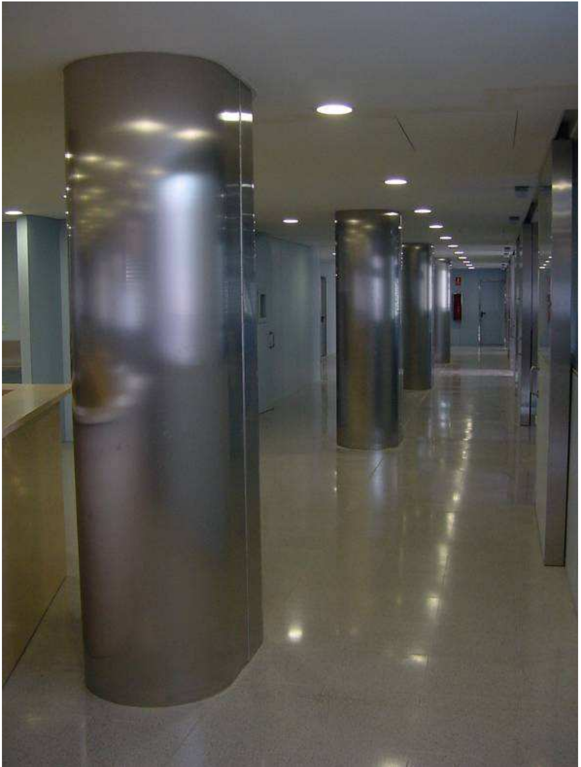
DETALLE DEL FORRADO DE COLUMNAS Y CANTONERAS DE MARCOS DE PUERTA COMO PROTECCIÓN
